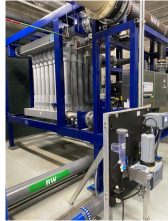
New membrane skid (Evoqua)
